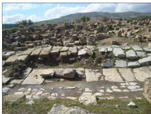
Photos 01 : Bombements, affaissement et enlèvements du revêtement des chaussées affectant la rue principale N-S (Cardo) et la rue du Forum.
