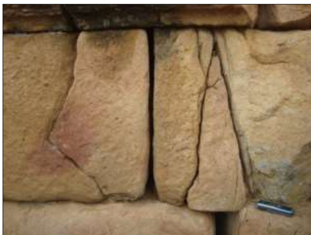
Figure 09: des fissures observées sous l'effet du changement de la température.
