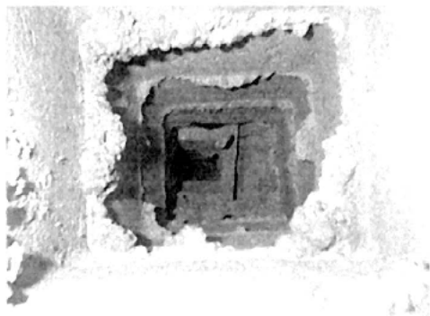
Photo N°1 : Défaut de lissage à l'intérieur du conduit de fumée
