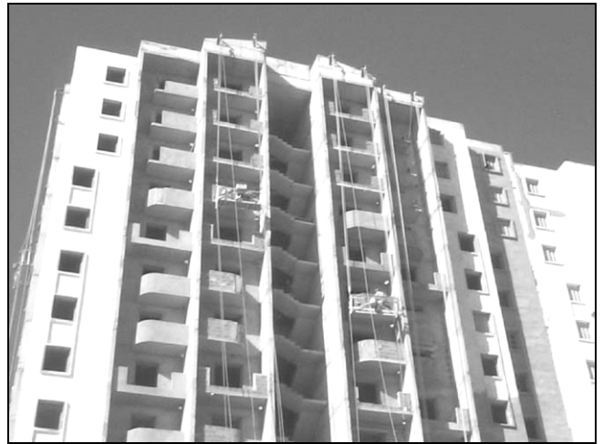
Photo 2: L'utilisation de la corde lors des travaux de finition dans les chantiers de l'A.A.D.L. (Fév. 2004).
