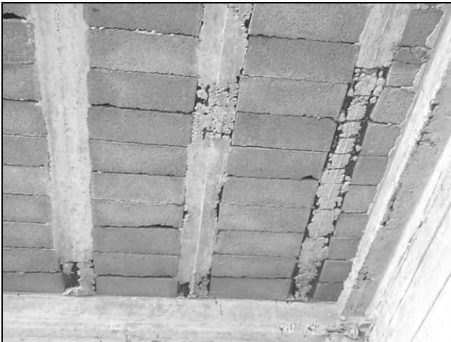
Photo 1: Mauvaise qualité de l'hourdis et des poutrelles (Oct. 2003).
