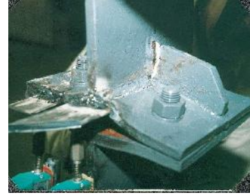
Photo 6 : Rupture du cordon de soudure-tp=10mm
