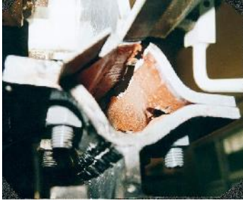
Photo 3 : Platine ruiné au droit de semelle tendue et traversée par les Boulons- tp=8mm
