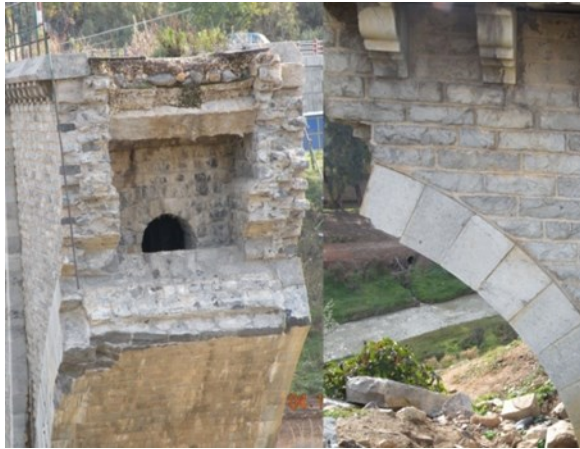
Photo 11 : un viaduc (transport ferroviaire) voie Piétonne endommagée par la rupture de l'une de ses Source : Hamrouchi K
