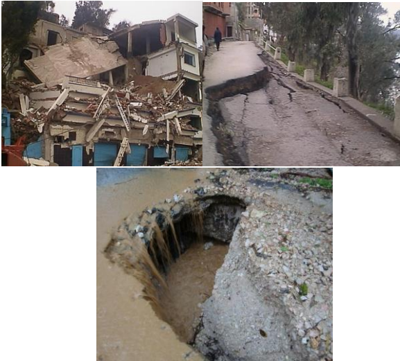
Figure 11 : Désordres de 2005 à Stora.
