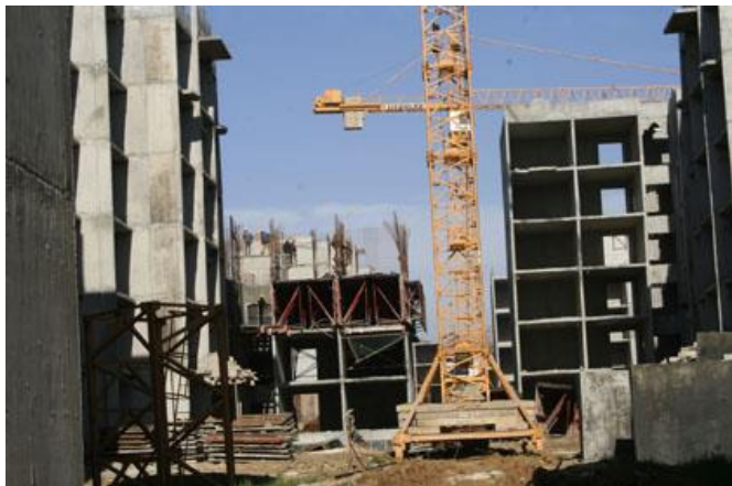
Figure n°01 : le projet des 1680 logements en cours de réalisation (voiles et dalles).Source : OPGI, 2011.
