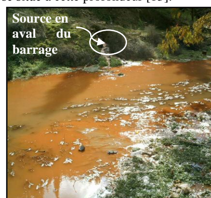
Photo 3: Les écoulements en aval du barrage accompagnés d'argile rougeâtre
