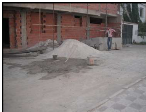
Photo 29 : dépôt de matériaux de construction sur la chaussée
