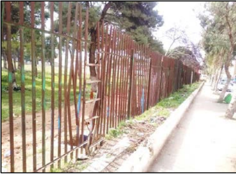
(Fig.6). la dégradation du la clôture de la pinède du khroub. Source : photo prise par l'auteur, (2015)
