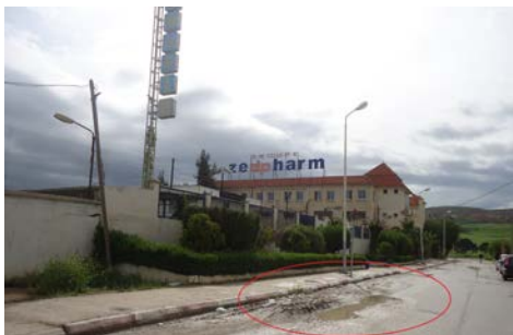
(fig. 4 et 5) : exemple de l'état des VRD dans les deux Zones industrielle Palma , et zone d'activités le Rhumel
