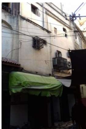
Photo n° 11: Maison n° 2 rue Sidi Naamoune transformée en commerce d'alimentation mais à être supprimer selon le PPSMVSS Source : auteurs 2019
