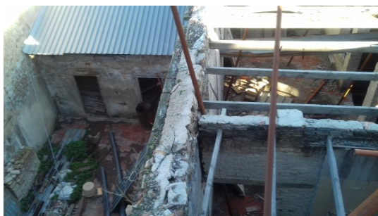
Photo n°2 : vue plongeante sur l'état actuel d'une maison avec un hamam n°13 de la rue Sidi Nemdil abandonnée par l'entreprise de réhabilitation (événement 2015). Source : auteurs 2019
