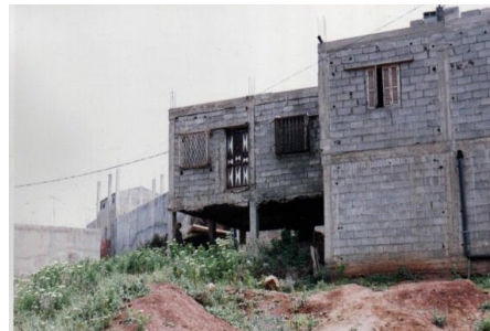
Photo 5 : Défaillance dans la maîtrise des niveaux des seuils. Cliché : C. Moussannef. 2001
